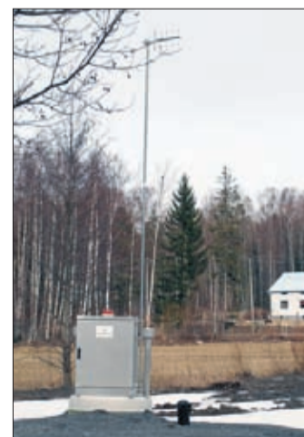
Avloppsledningens åtta pumpstationer både övervakas och fjärrstyrs via datorer.
